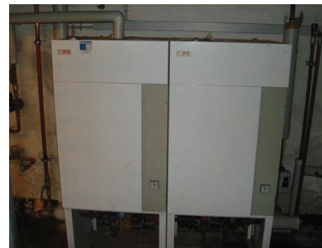
Varmtvandsbeholdere i varmecentral
