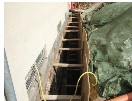
Eksempel på nødvendig fugtsikring af kælder – ikke jeres ejendom
