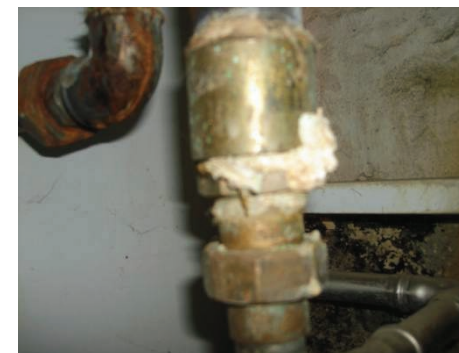
Tærede messingfittings under varmtvandsbeholdere
