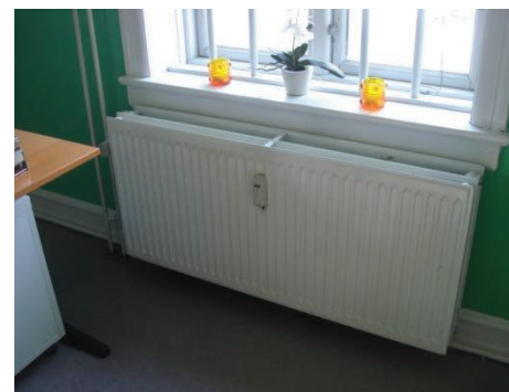
Radiator med elektronisk varmemåler og termostatventil
