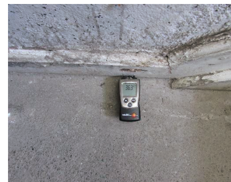
Fugtindhold i træværk ved kældergulv ved trappe til kælder.
