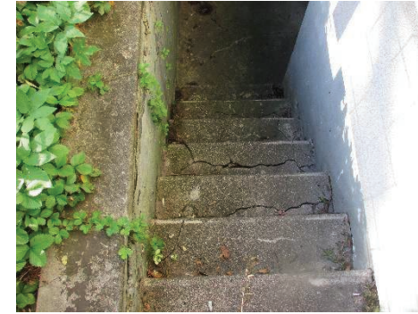
Kældertrappe med revner i trin
