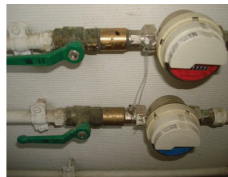
Vandmålere på varmt og koldt vand
