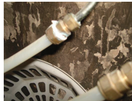
Tæring ved messingfittings
