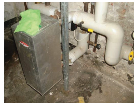
Pladevarmeveksler i varmecentral
