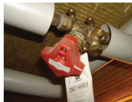
Strengreguleringsventil på radiatoranlæg
