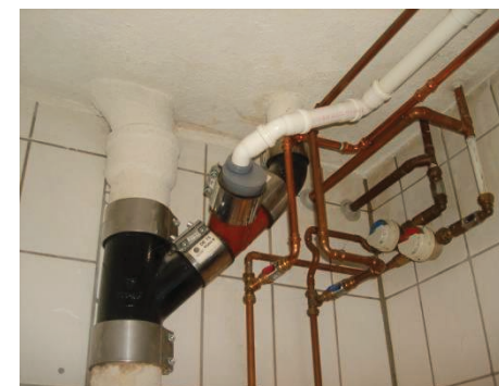
Brugsvandsinstallationer er udført af kobberør
