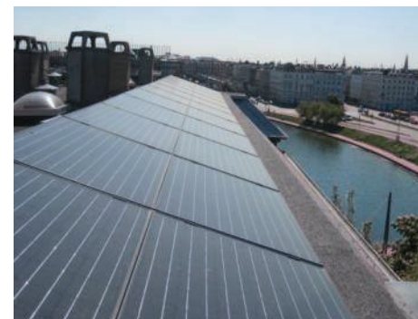
Eksempel på solcelleanlæg
