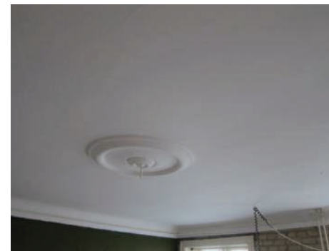
Loft med fine revner
