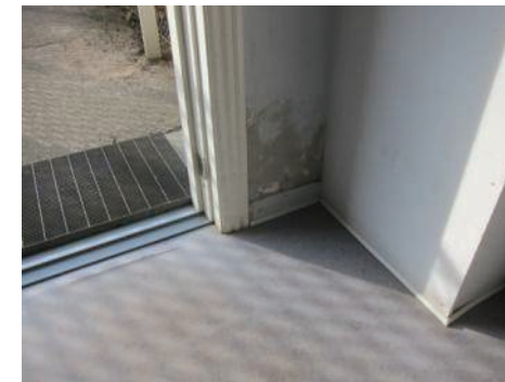
Afskalning ved opgangsdør
