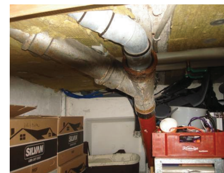
Toiletfaldstamme i kælder, med parti- elle reparationer
