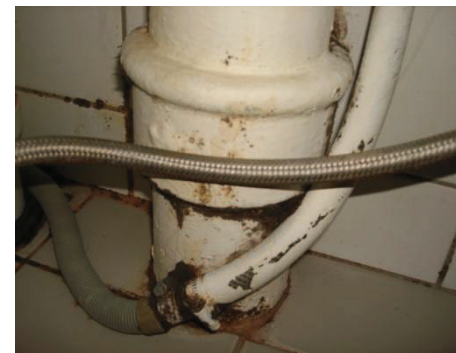
Toiletaldstamme i støbejern i lejlighed
